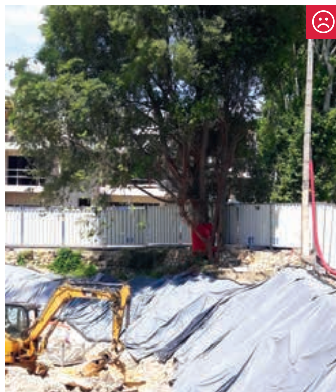
MICOCOULIER, NON RESPECT DES DISTANCES CHANTIER-ARBRE , AVENUE DU JEU DE MAIL DES ABBÉS
