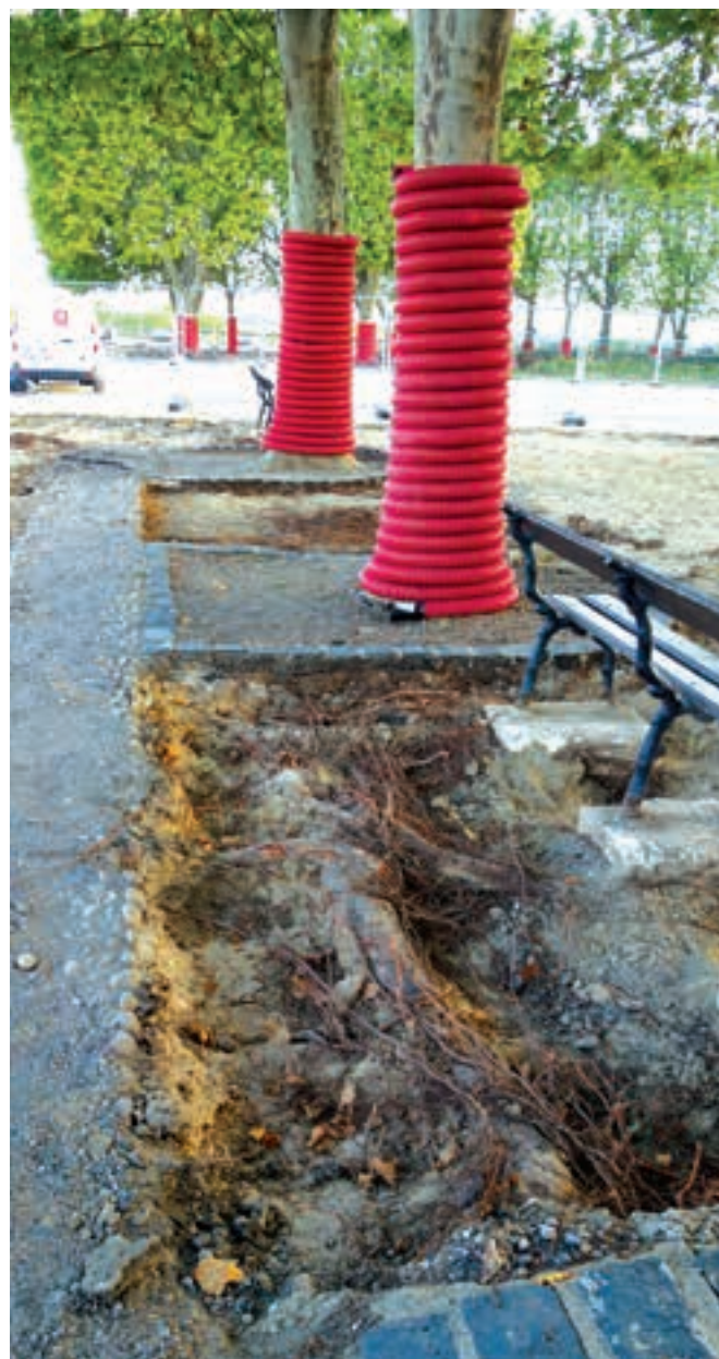
TRAVAUX DE RÉFECTION DES REVÊTEMENTS À PROXIMITÉ DES PLATANES, PROMENADE DU PEYROU (SOURCE : POUSSE CONSEIL)
