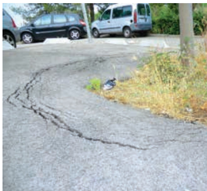
AFFAISSEMENT D'UNE FOSSE DE PLANTATION
