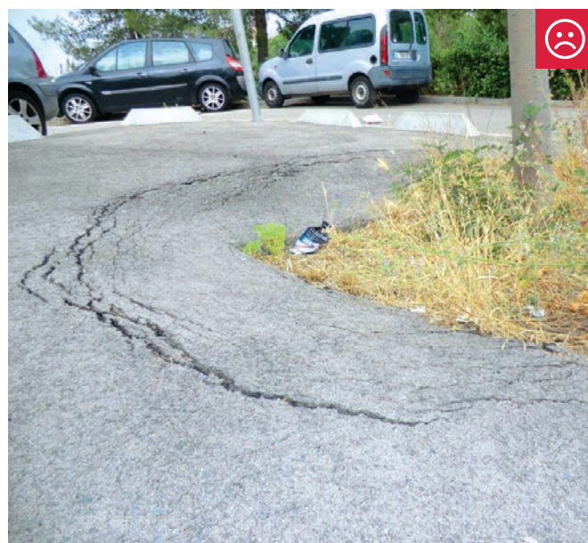
AFFAISSEMENT D'UNE FOSSE DE PLANTATION
