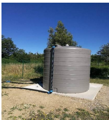
Citerne de stockage des EUT installée sur la STEU de Saint-Drézéry
