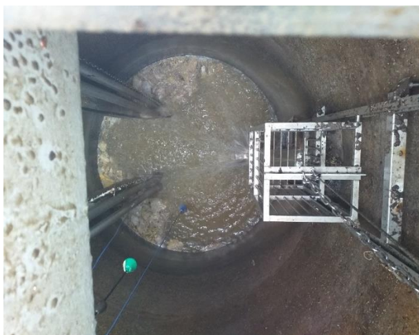
Figure 2 - PR Village - Saint-Drézéry - cuve avec panier dégrilleur
