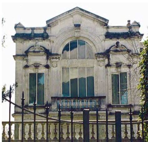
La mise en place de doubles fenêtres au nu extérieur nuit à l'harmonie d'origine
