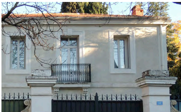
Le remplacement de la fenêtre par un modèle strictement identique à celui d'origine est quasiment imperceptible
