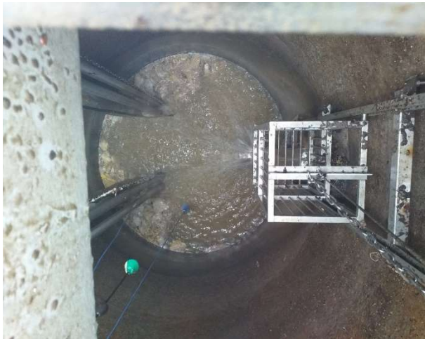
Figure 2 - PR Village - Saint-Drézéry - cuve avec panier dégrilleur
