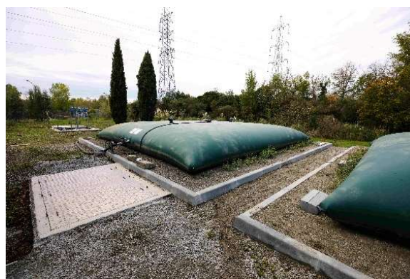
Bâches de stockage
